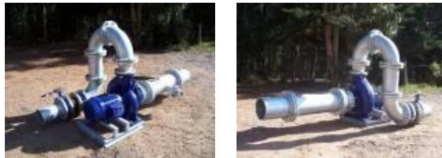
Bomba de lavado, tuberías de succión e impulsión
