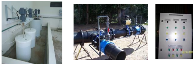
Kit de Dosificación, punto de inyección y su respectivo tablero de comando y control
