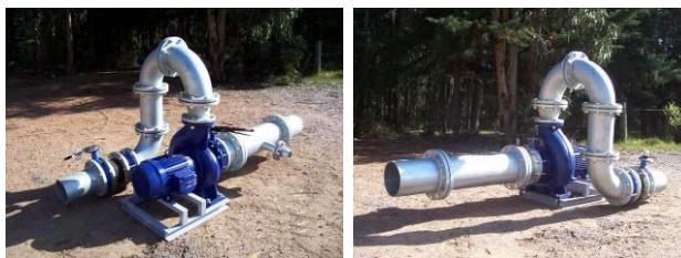
Bomba de lavado, tuberías de succión e impulsión
