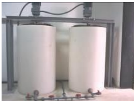
Kit de Dosificación con sus respectivas bombas dosificadoras y tanques de preparación de PPQQ.
