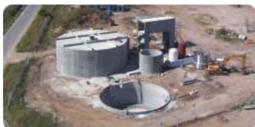
Planta Depuradora CIM Conaprole (2004). Montevideo, Uruguay. - 120 m 3 /h.
